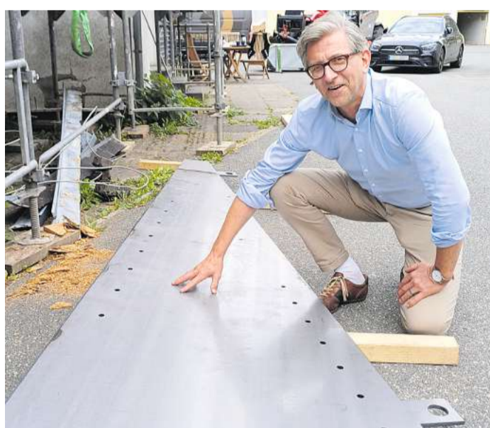
Größer als Kino-Geschäftsführer Jan-Per Sellmer sind die dreieckigen Bleche, die in die Holzträger des alten Daches zur Sicherung eingebaut wurden.
