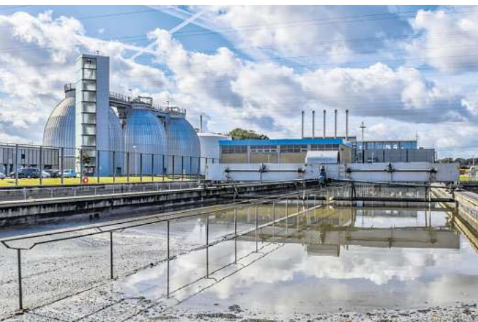
Das Klärwerk Bülk reinigt seit 1972 das Abwasser aus den Häusern, und Haushalten Kiels. Auf welchem technischen Stand die Anlage heute ist, zeigt eine Führung kostenlose Führung am kommenden Dienstag.
